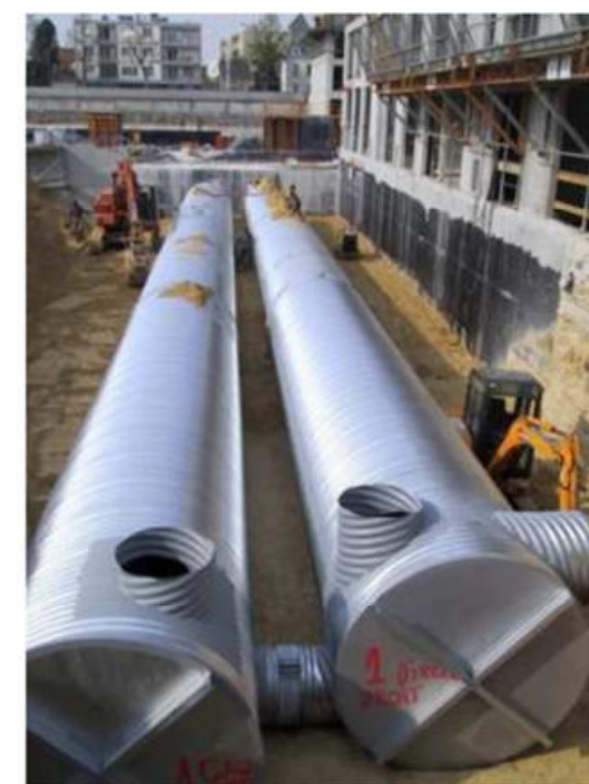
Figure 12 : Exemple de buse de rétention
